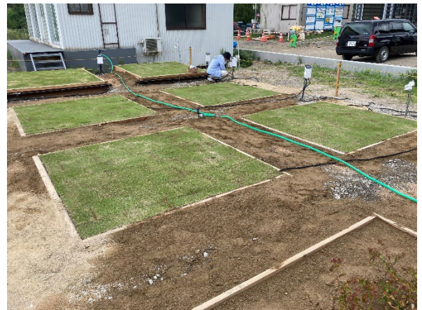
写真-2 団粒化構造を活用した「アーバン・グリーンダム」プロジェクト
